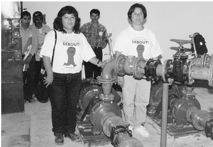
Les ingénieures Norma Guillen et Mercedes Torres dans la station de pompage
