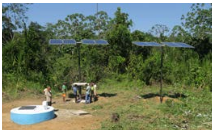
Shirintiari : les 8 panneaux solaires près du puits
