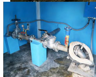
Station de pompage de La Ramada
