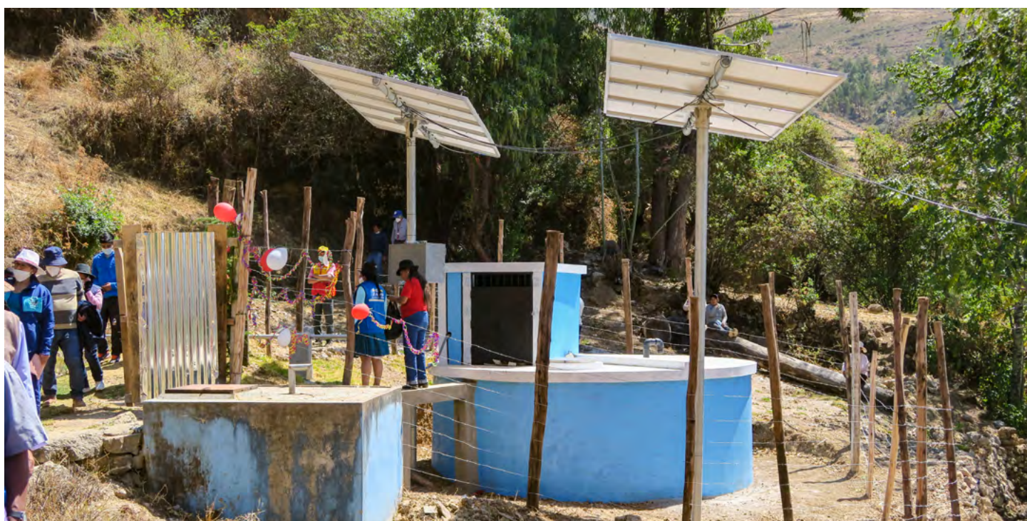
La citerne et les panneaux solaires de Rayme Alto
