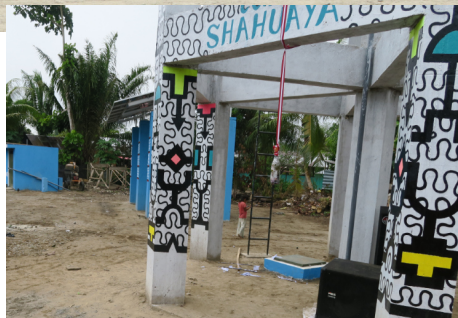
Les colonnes du réservoir peintes aux motifs et couleurs de la culture Shipibo-Konibo
