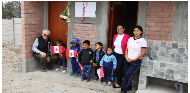
Notre équipe péruvienne est retournée à Nueva Esperanza pour installer une entrée d'eau à l'école maternelle et construire une toilette écolo pour les bambins
